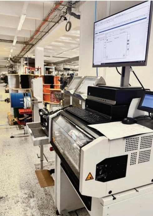
线缆切割系统（前端）、放线机、自动裁线机、绕线机与打印机
